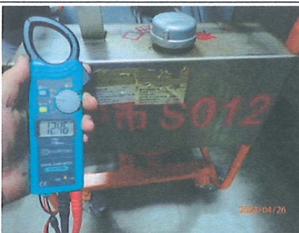
3 英吋油械式抽水機-S012 (檢查電壓)
