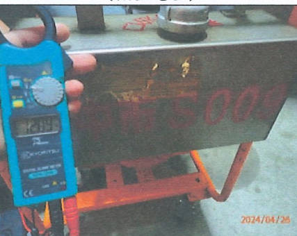
3 英吋油械式抽水機-S009 (檢查電壓)
