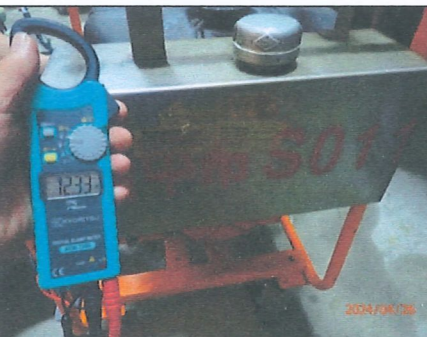
3 英吋油械式抽水機-S011 (檢查電壓)
